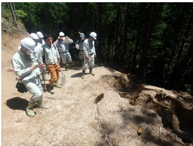
路網の洗堀及び路肩崩壊箇所
